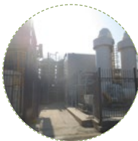
氨氮废水处理设施
