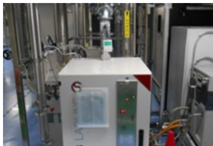
废气本地处理设备
