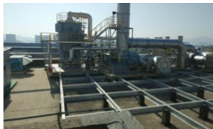
有机废气处理系统
